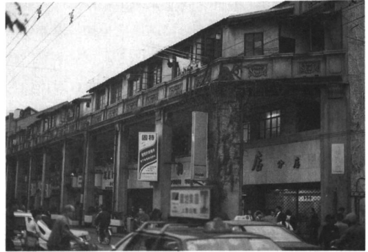
写真3 金陵東路の停仔脚(騎樓) (田中智司撮影) 上海市では金陵東路沿いにのみ停仔脚がみられる。
